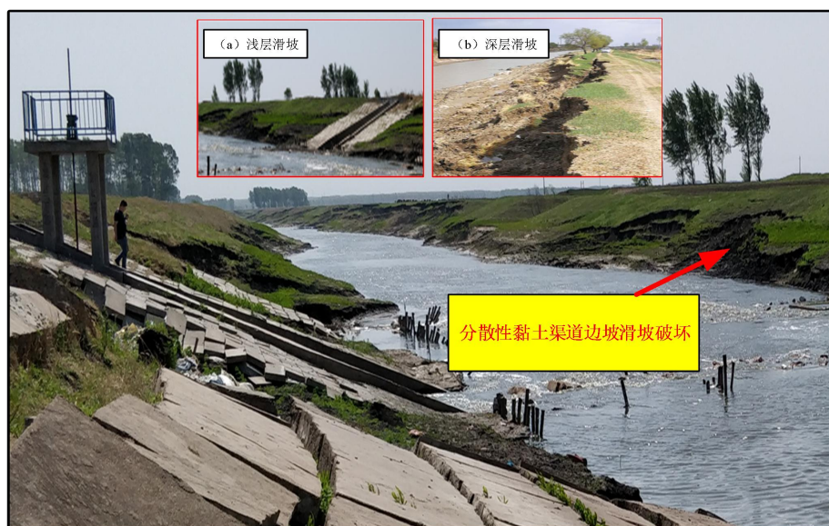
图2 东北地区分散性黏土经过冻融循环和浸泡作用后的滑坡破坏
